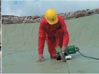
TWINNY T pour l'emploi dans un bassin de rétention d'eau.
